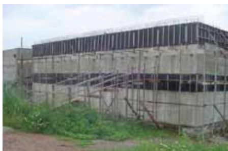
Parte do reator da ETE Tijucal
