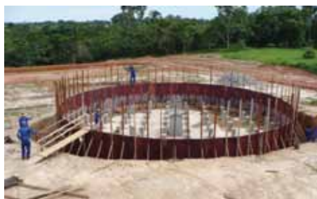
Decantador Secundário da ETE Redenção
