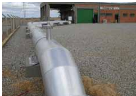
Estação pressurização EP 220
