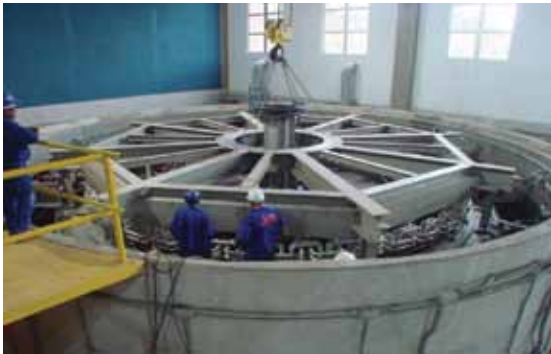
Vista da Unidade Geradora 2
