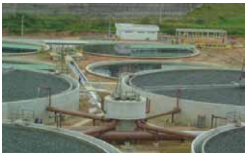
Vista geral da ETE Onça
