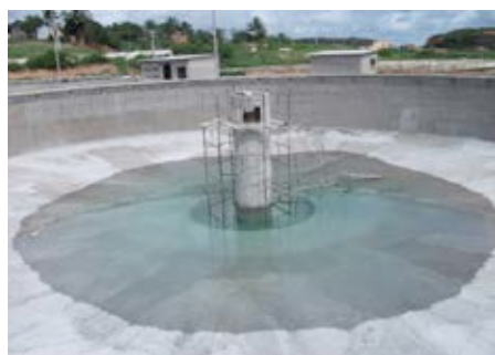
Decantador da ETE ERQ Sul
