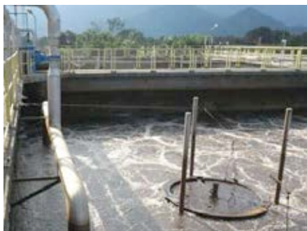
ETE Bertioga – tanque de aeração
