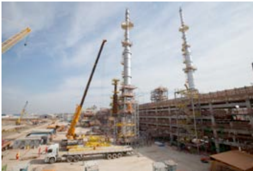
Unidade de Hidrotratamento de Querosene – Comperj
