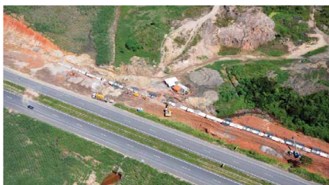
Adutora de Água Tratada – Sistema Pirapama
