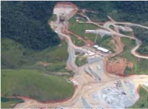
Casa de força e canal de fuga
