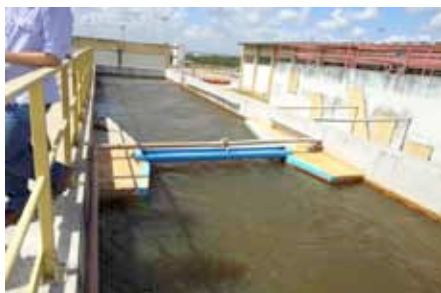
Medidor de vazão da ETA Gramame
