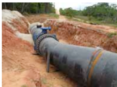
Adutora de água bruta - Captação Joanes
