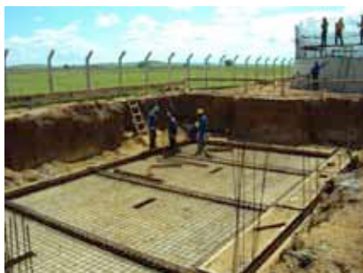
Estação Elevatória de água tratada
