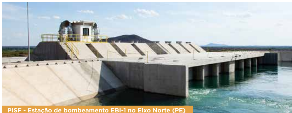
PISF - Estação de bombeamento EBI-1 no Eixo Norte (PE)
