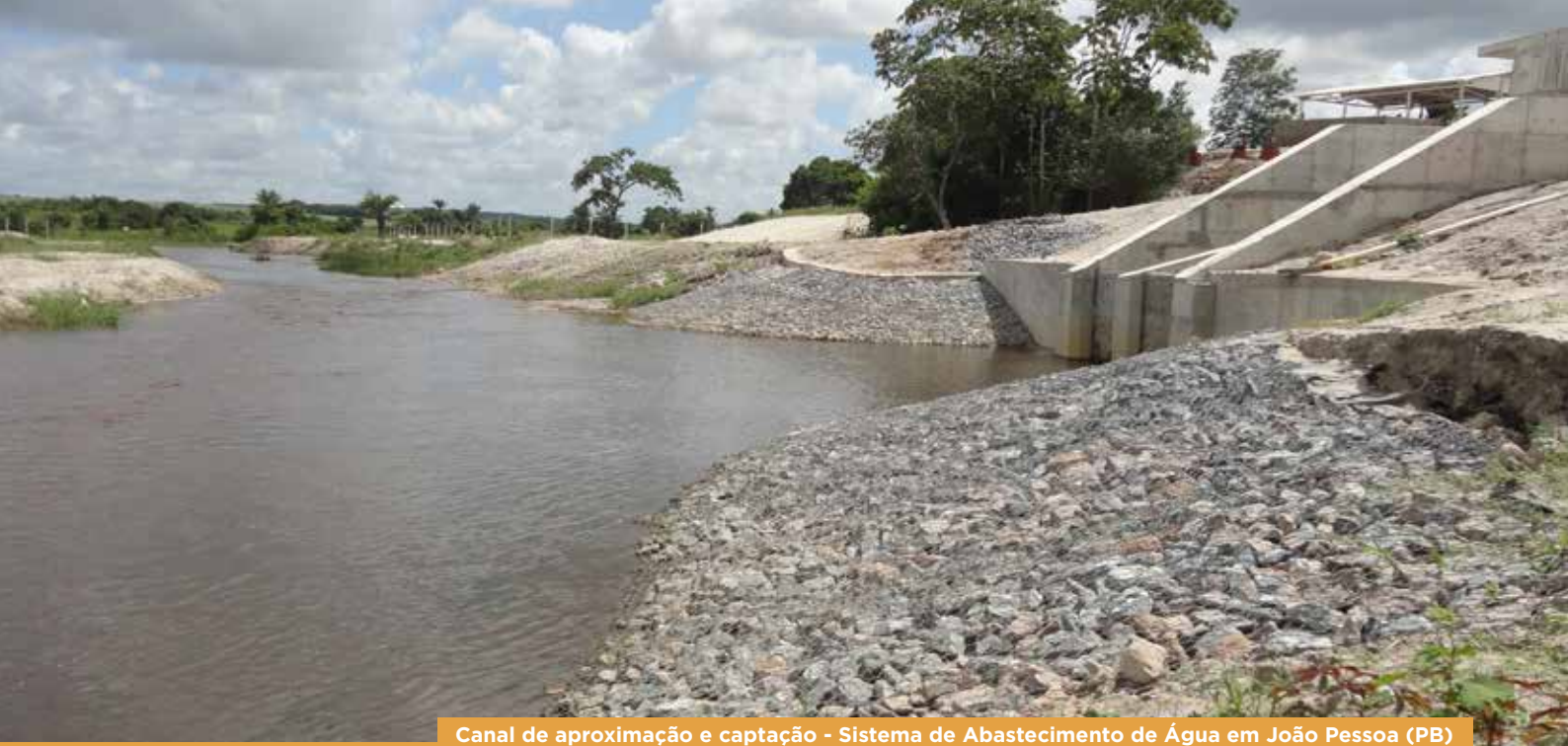
Canal de aproximação e captação - Sistema de Abastecimento de Água em João Pessoa (PB)
