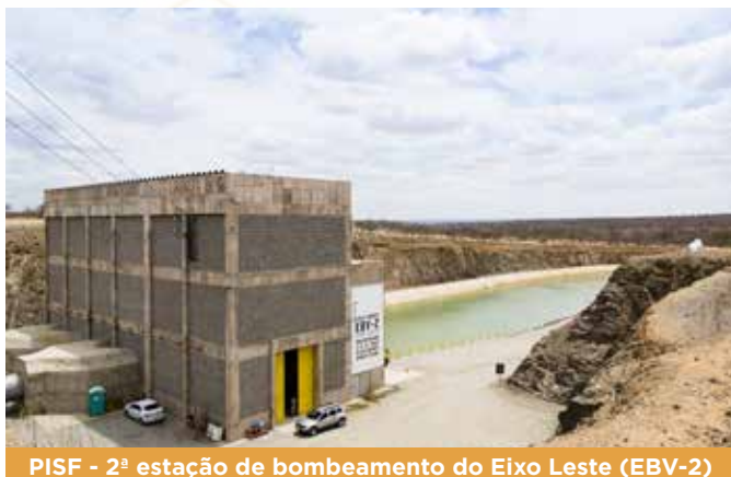
PISF - 2ª estação de bombeamento do Eixo Leste (EBV-2)
