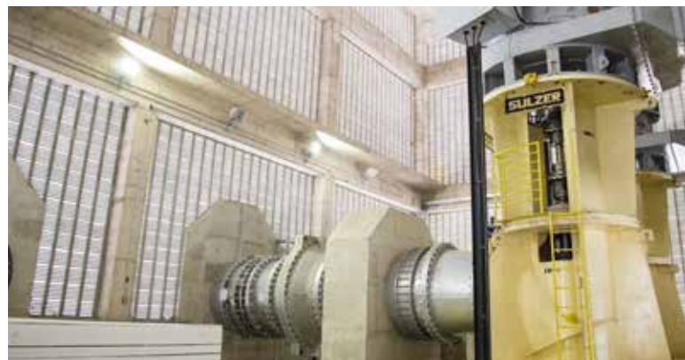
PISF - 2ª estação de bombeamento do Eixo Leste (EBV-2)
