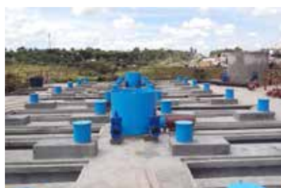
Reatores UASB da ETE Veneza – Ribeirão das Neves
