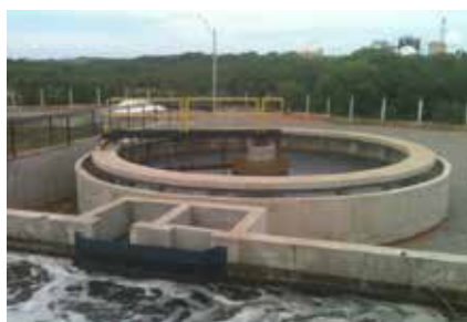
ETE – Tanque de Aeração e do Decantador Madre de Deus
