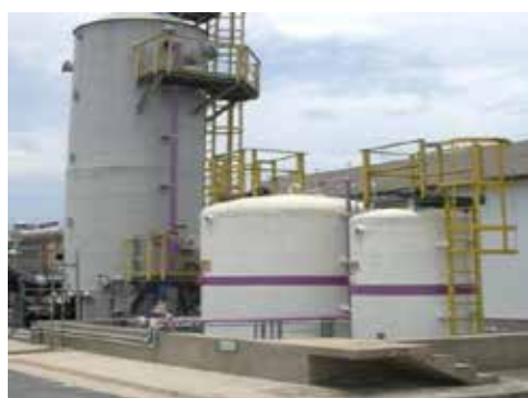
EPC Praia Grande – Sistema de cloração e desodorização
