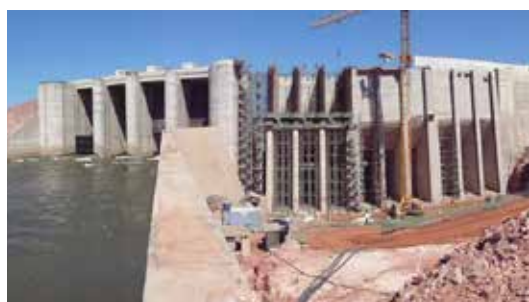
Circuito de Geração – Vista montante
