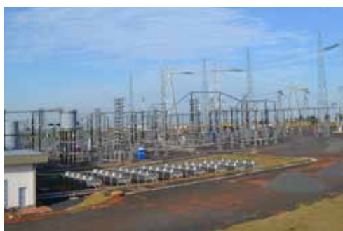
Interligação Madeira-Porto Velho-Araraquara – Estações conversoras
