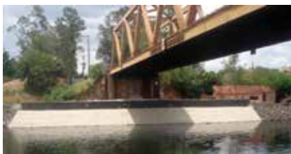
Canal de Igaráçu – Reforço da proteção dos pilares da margem direita concluído
