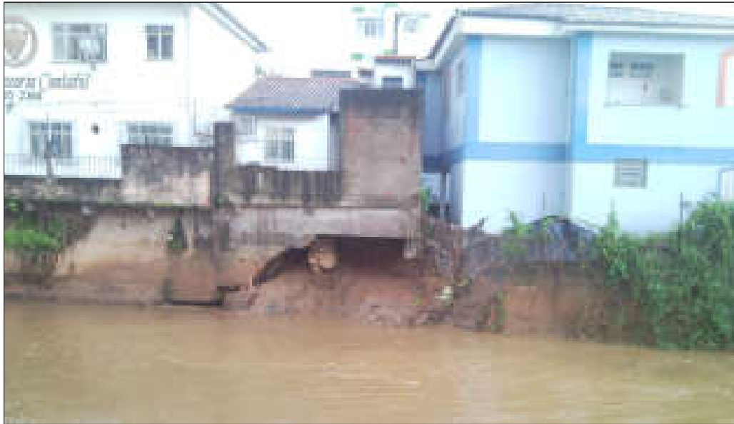
Figura 5-23: Solapamento de fundação colocando imóvel em risco. Foto do autor 2010.
