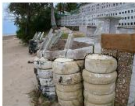
Contenção precária e Irregular contra erosão marinha
