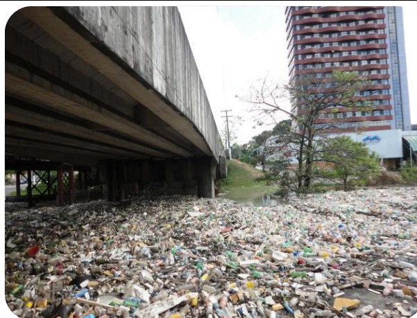
Foto 5.1.2-3 – Ponte Avenida Constantino Nery sobre o igarápé do Mindú a partir do Parque dos Bilhares - Detalhe dos resíduos sólidos acumulados na superfície do curso d'água.
