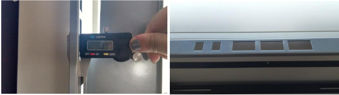
Figuras 16 e 17 – Calha para passagem de fiação.
